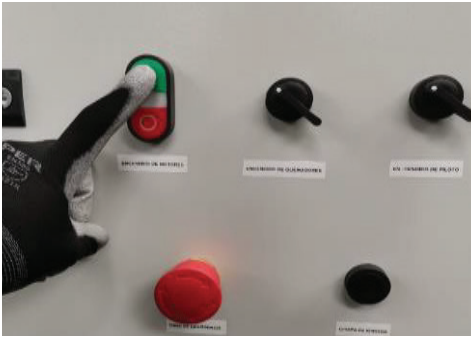
C Oprimir botón verde (ON) encendido de motores
